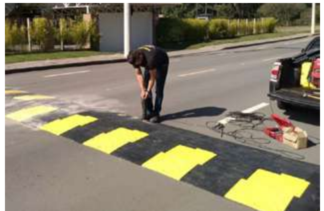
↑ Teresina, Brasil. La implantación del reductor de velocidad (lomo de burro) es recomendable cuando se desea bajar la velocidad vehicular. Es posible implementar el reductor de velocidad a partir del reciclaje de materiales, en el caso de Teresina lo hicieron con restos de neumáticos. Imagen: https://strans.pmt.pi.gov.br/2020/01/22/teresina-tera-a-primeira-lombada-ecologica/
