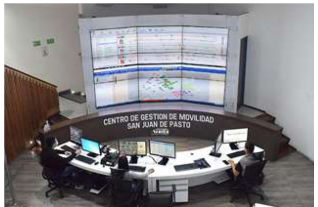
↑ San Juan de Pasto, Colombia. El Centro de Gestión de Movilidad integra el control del sistema semafórico, del sistema de gestión y control de flota, y del sistema de recaudo centralizado. Imagen: https://avante.gov.co/nuestros-proyectos/
